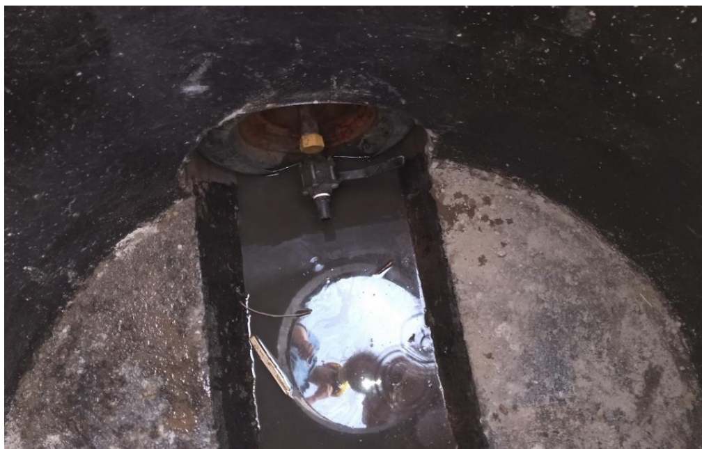
Ilustración 14: Tapón en cañería para prueba hidráulica
