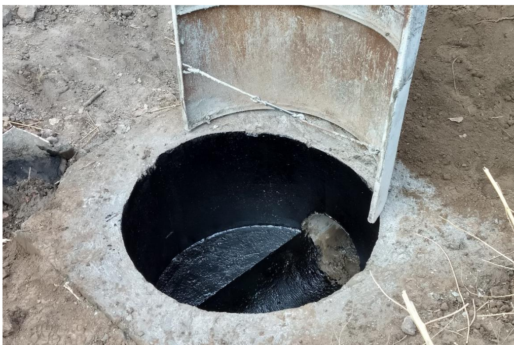
Ilustración 13: Cámara de registro sin losa, con pintura epoxi de 2 componentes
